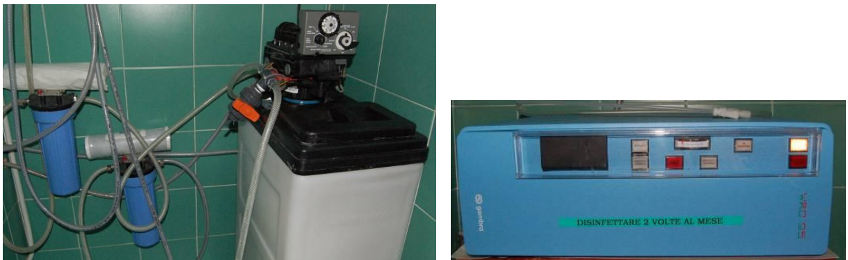
Fig n° 5. Sistema di depurazione dell'acqua; sopra: filtri ed addolcitore; sotto: osmosi inversa.
